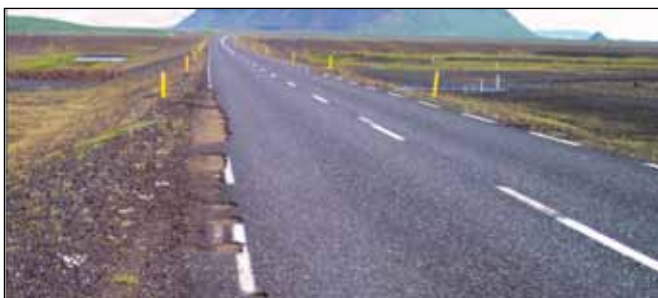
Slæmar vegaxlir á Hringvegi (1).
