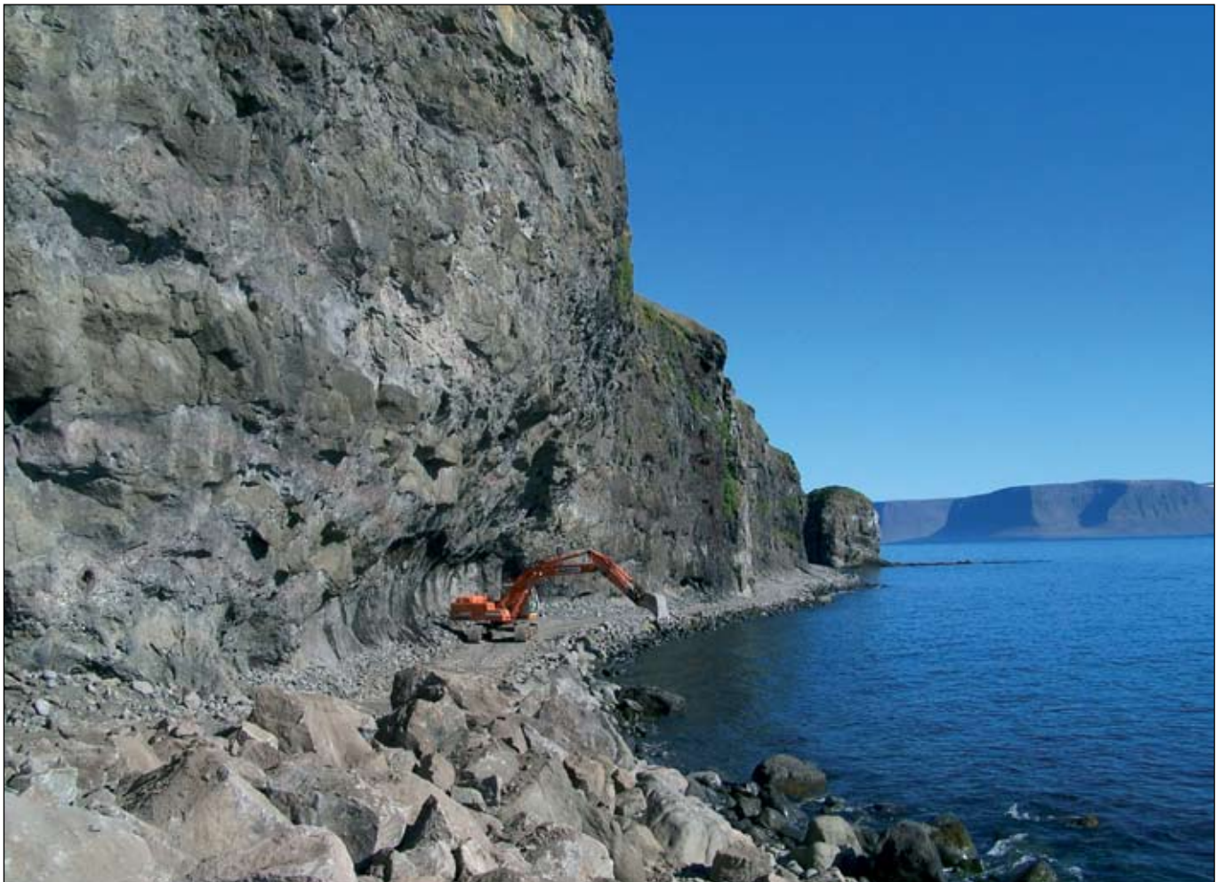
Undir Skútabjörgum í norðanverðum Arnarfirði. Þessi vegslóði liggur fyrir nesið norður í Dýrafjörð um Svalvoga. Valdemar Jónsson verktaki í Öfundarfirði tók myndina þegar unnið var að opnun vegarins í vor. Til þess fær Ísafjarðarbær styrk úr styrkvegasjóði en Vegagerðin stjórnar verkinu.
