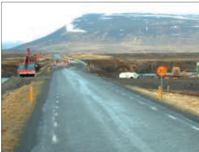
Nú standa yfir framkvæmdir við breikkun brúar á Hróteyjarkvísl á Hringvegi hjá Bárðardalsvegi eystri. Mynd Hafdís E. Jónsdóttir.
