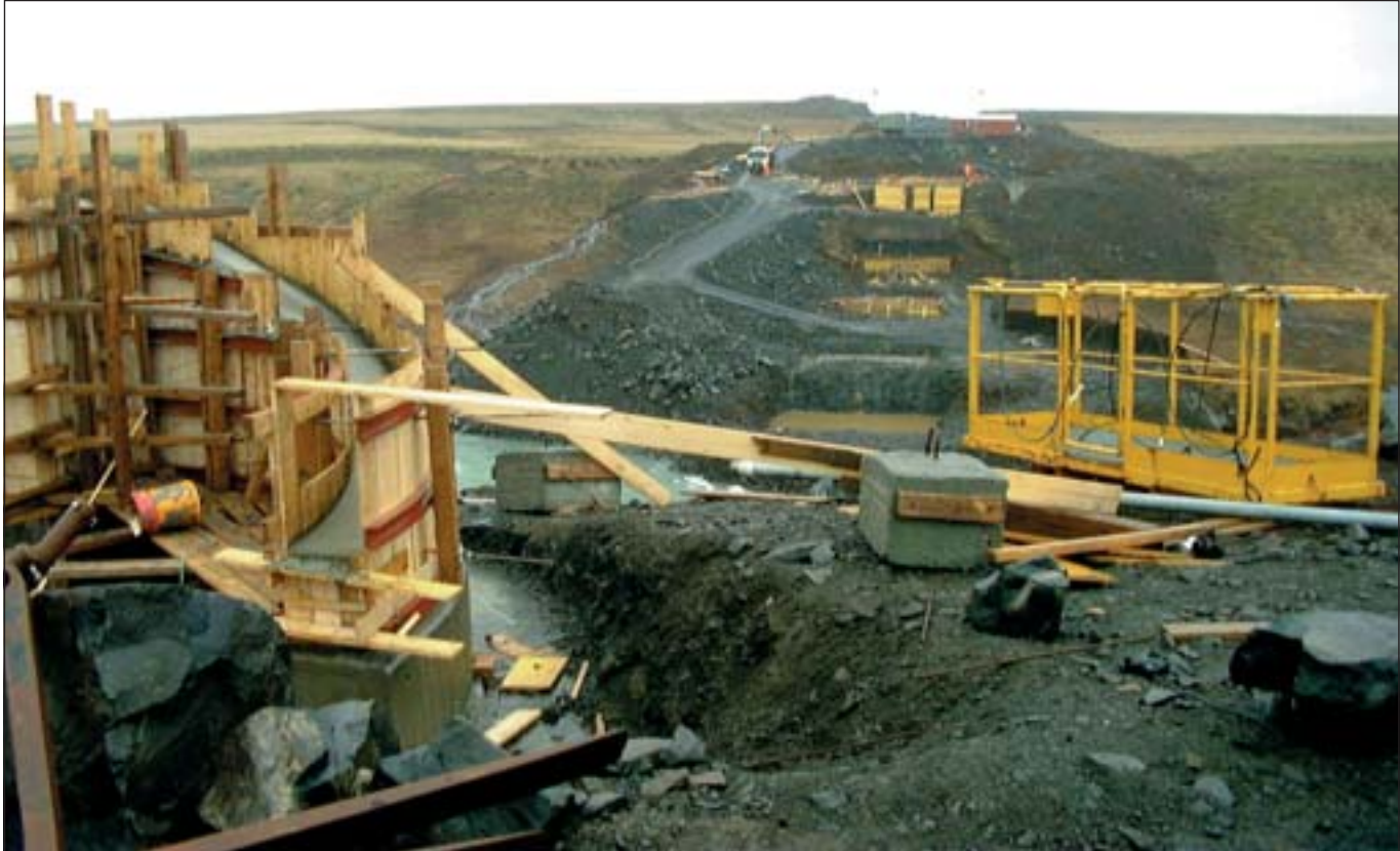
Framkvæmdir við nýja brú yfir Þjórsá 4. apríl sl. Mynd: Ólafur Þór Gunnarsson.
