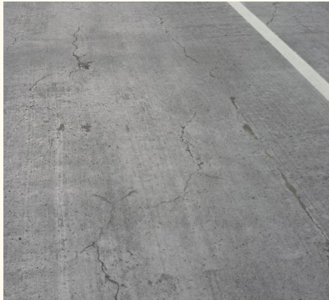
Sprungur í burðarsteypu á nýlegri brú, án slitlagssteypu Brú yfir Múlakvísl byggingarár 2014
