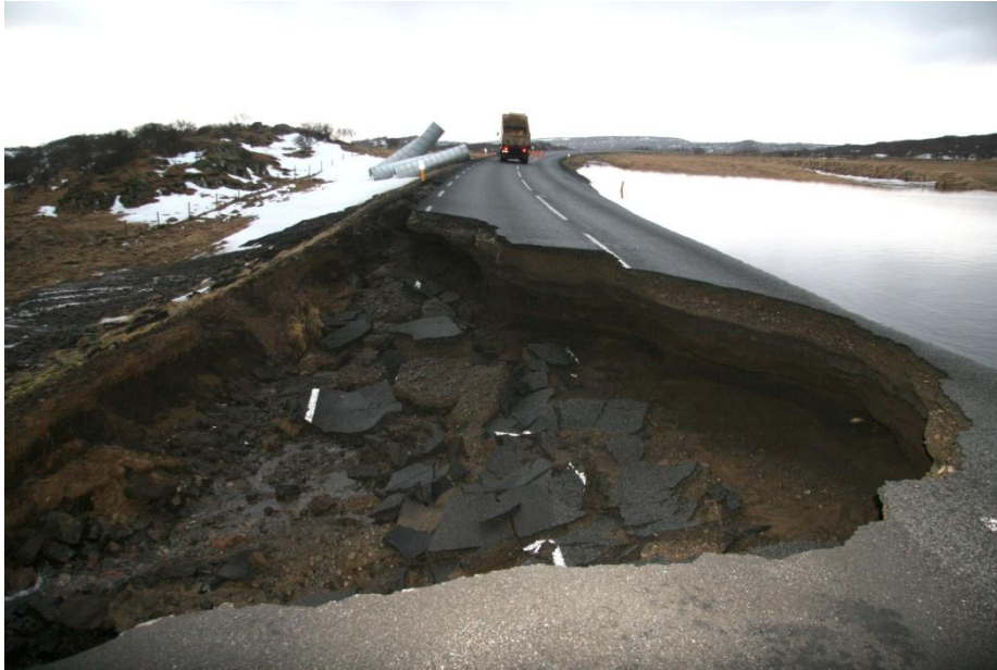
Mynd 3 Vatnstjón á Hringveginum við Daníelslund í Borgarfirði í kjölfar flóðs vegna asahláku 18. febrúar 2008 (ljósm. Skessuhorn)
