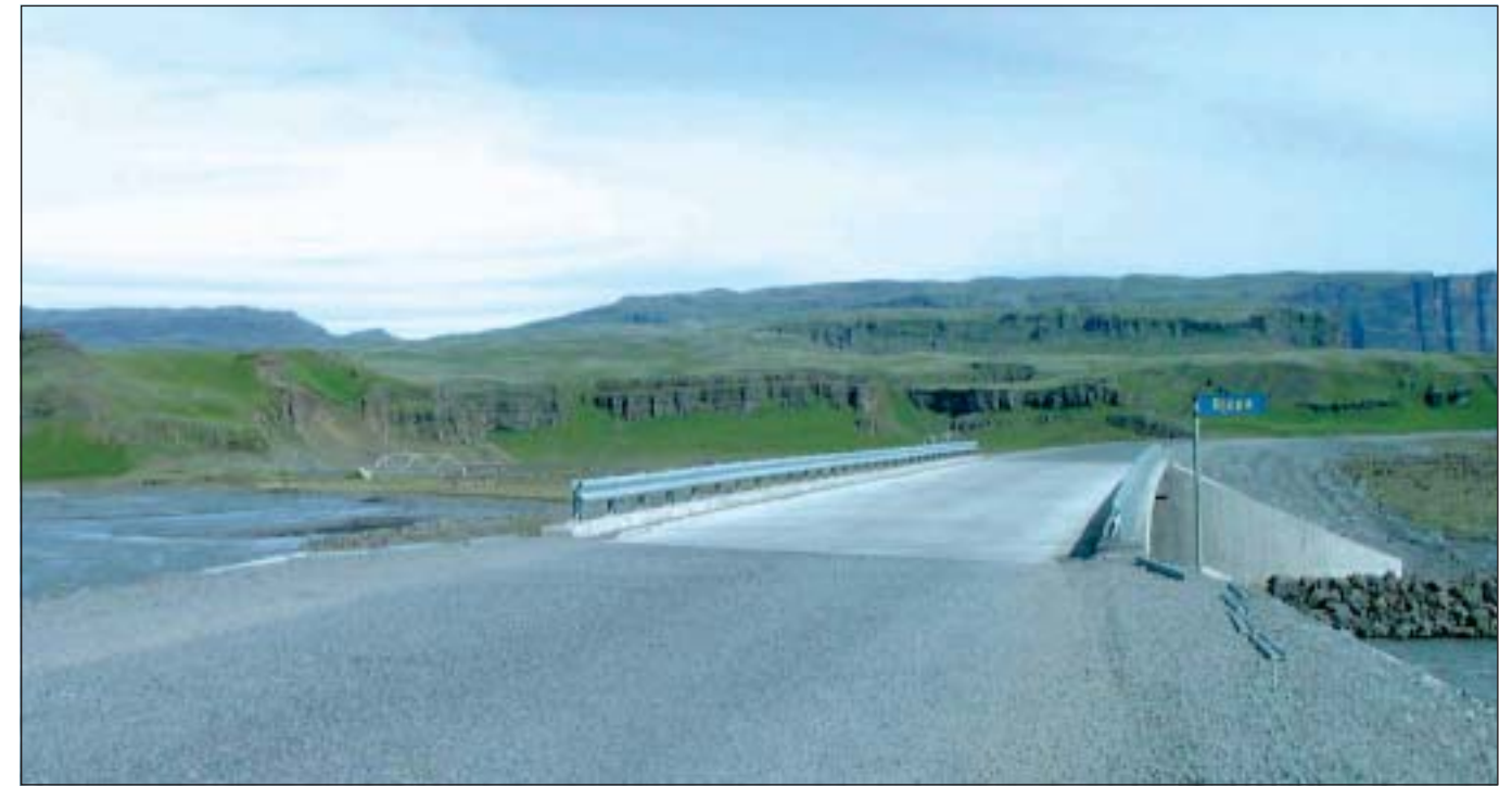
Hringvegur í Fljótshverfi, Vestur-Skaftafellssýslu. Ný brú yfir Djúpa er nú fullgerð en í baksýn má sjá gömlu brúna sem var bæði þröng og með takmarkað burðarþol.
