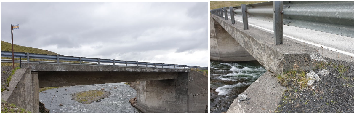
MYND 6.2 Steypuskemmdir í útkanti brúar yfir Norðurá hjá Sveinatungu (byggð 1983). Mynd frá 2022.
