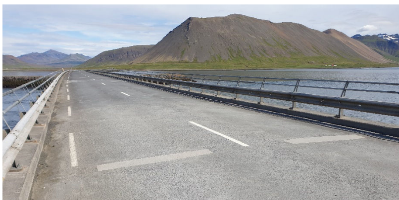
MYND 6.19 Brú yfir kolgrafarfjörð. Úrtök yfir millistöplum með viðgerðarefni.
