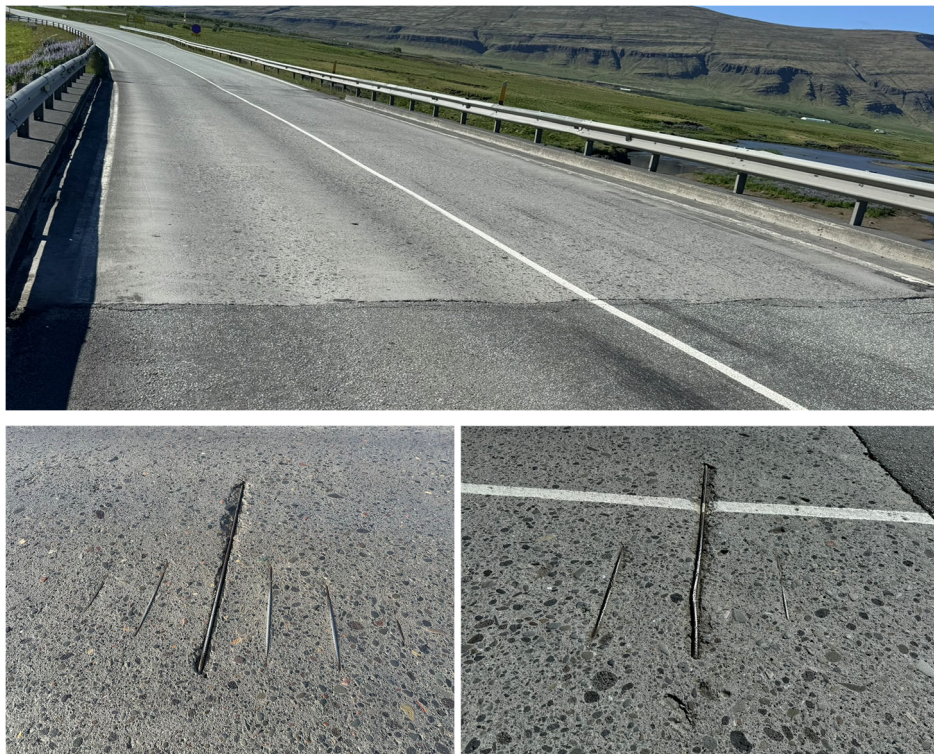
Mynd 16 – Sjónmat yfirborðs brúar yfir Laxár í Leirársveit. Myndir frá því í júní 2024, sýna ástand Laxárbrúar fyrir viðgerð. Brúargólfið var komið í verulega slæmt ástand. Slitið orðið mjög mikið og víða sást í steypustyrktarjárn.
