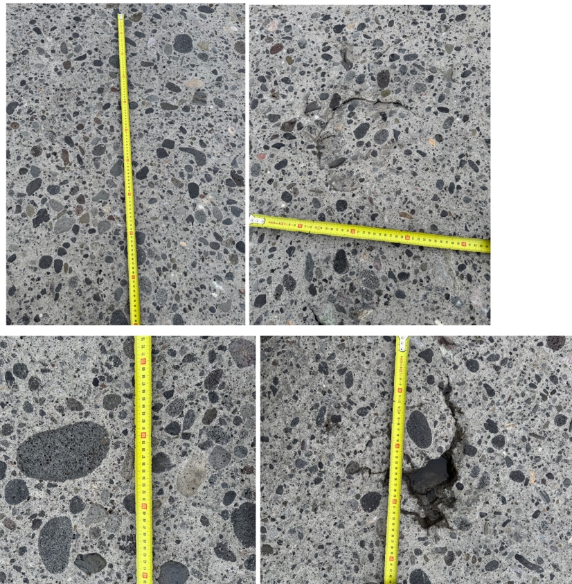
Mynd 19 – Sjónmat yfirborðs brúar yfir Gljúfurá 2024. Brúargólfið er í verulega slæmu ástandi. Eftirfarandi myndir sýna frost/þíðu skemmdir á yfirborði ásamt sprungum. Steinefni er í mismunandi stærðum (60 x 120 mm stærst) og dreifist illa.
