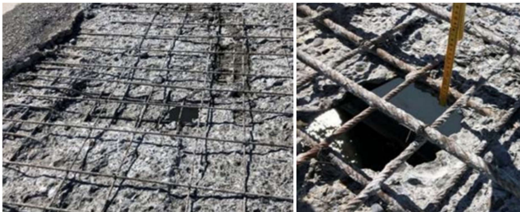
Mynd 2 – Viðgerð á brú yfir Miðfjarðará 2017. Yfirborð brúar var fræst, steypan reyndist illa farin svo nauðsynlegt þurfti að vatnsbrjóta, á sumum stöðum var vatnsbrotið í gegnum brúargólfið.
