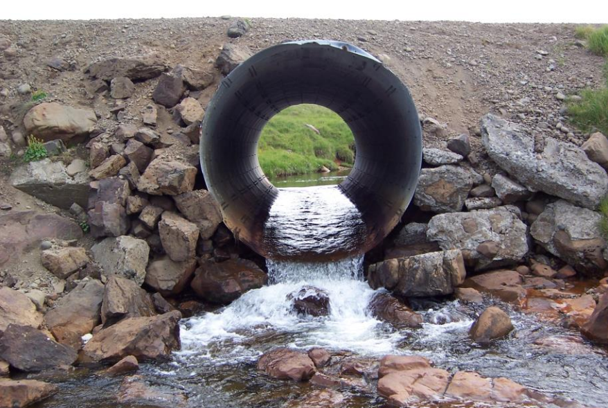
Ávíkurá, Árneshreppi á Ströndum. Grjót við útfall hindrar ferðir fiska upp ræsi. Ræsi þrengir talsvert að árfarvegi.
