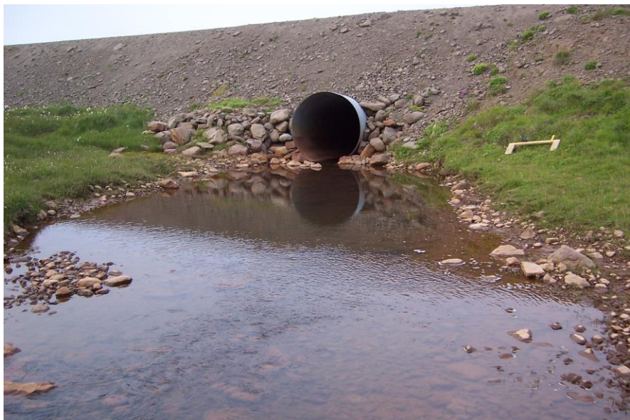
Lækur við Reykjarnes, Árneshreppi á Ströndum. Inntak ræsis. Vel sést hve mikið ræsi þrengir að lækjarfarveginum.
