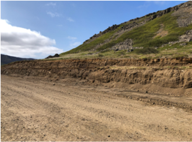
↑ Þar sem ekki mátti fara út fyrir skilgreint framkvæmdasvæði urðu skeringar í lausum jarðlögum brattar. Erfitt mun reynast að græða upp slíkar skeringar.
