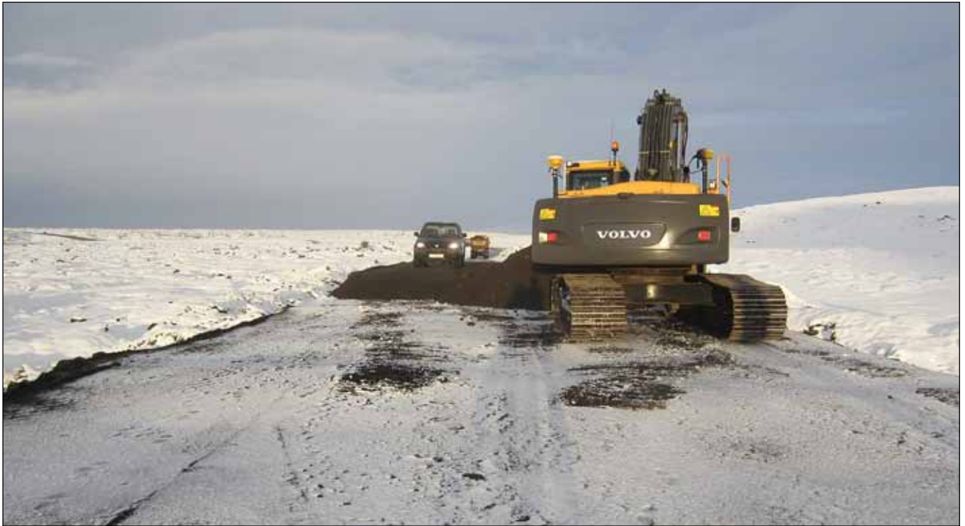
Hafin er vinna við breikkun Hringvegur (1) um Hellisheiði. Innifalið í því verki er gerð 1,8 km vegar frá Hamragilsvegi að skíðaskálanum í Hveradölum en sú framkvæmd er til að fækka vegamótum við Hringveg. Myndin hér að ofan sýnir vinnu við þann veg. Verktaki er Ístak hf.
