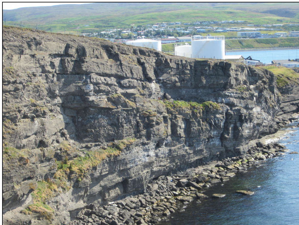
Ljósmynd 1. Dæmigert útlit setbergsins í Húsavíkurhöfða. Lárétt og hallandi lagskipting áberandi. Hæð bergvegsins um miðja mynd er ríflega 25 m.
