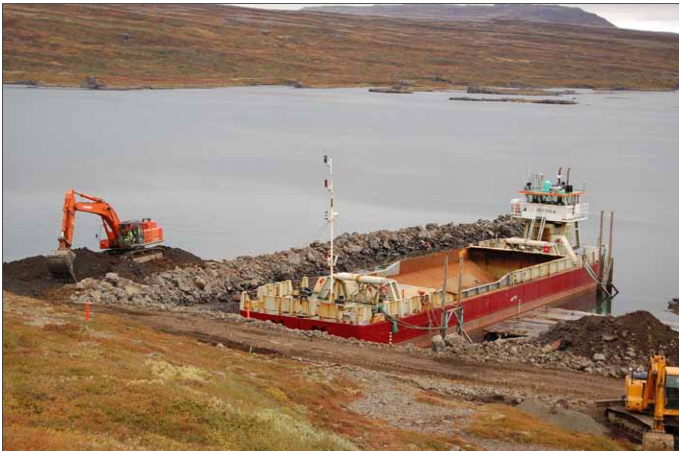
Vestfjarðavegur (60), Eiði - Þverá. Framkvæmdir í Mjóafirði. Verktaki er Suðurverk hf. Pramminn flytur efni í fyllinguna yfir fjörðinn. Hann tekur 400 m 3 fulllestaður en minna þegar lágsjávað er. Reiknað er með að hann muni fara 8 ferðir á dag. Sjá einnig mynd á baksíðu.
