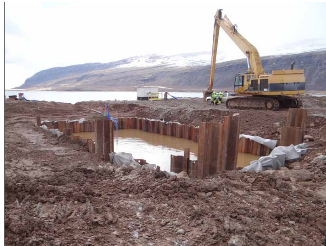
Brú og fylling á Kjálkafjörð. Hér má sjá vatnsstöðuna í fyllingunni. Sökkulstæðið bíður þess að dælt verði upp úr því. Á myndinni má sjá langa gröfuarminn sem notaður var til að færa út fyllinguna.
