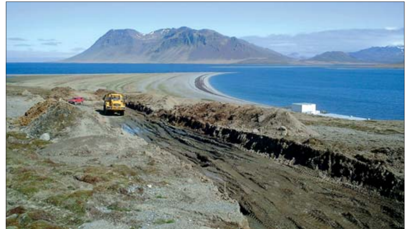
Framkvæmdir við Snæfellsnesveg (54) um Kolgrafafjörð eru nú hafnar. Verktaki er Háfell ehf. og Eykt ehf., Reykjavík.
