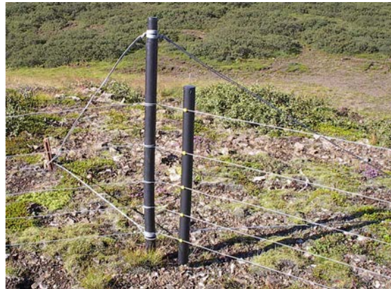
Mynd 1. Frágangur horn- og aflstólpa skiptir sköpum fyrir endingu og viðhald girðinga. Myndin sýnir hornstólpa og stög boruð í klöpp. (Ljósmynd Grétar Einarsson)
