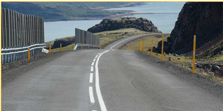
Skemmdar snjóvarnargirðingar á Kletthálsi (GPM).
