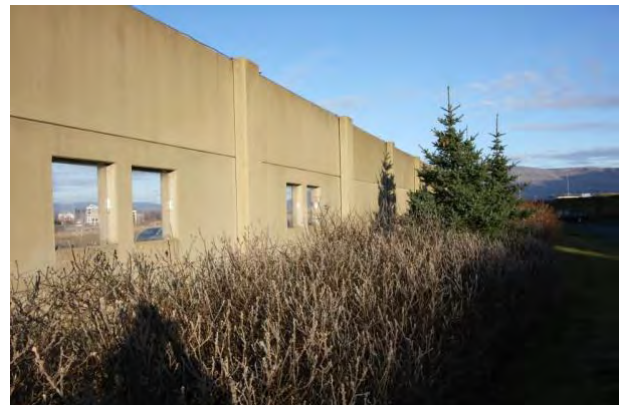
Mynd3-12 Steypur veggur við Sæbraut, séð frá íbúðum
