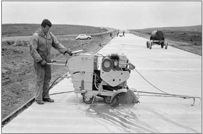
Mynd 251: 10. júlí 1963, vinna við lagningu Keflavíkurvegjar, Reykjanesbrautar. Maður vinnur með steinsög á nýsteyptum veginum. Sveinn Þormóðsson / www.ljosmyndasafn.reykjavik.is.
