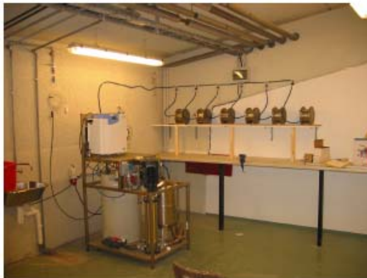
Figur 3.2 Foto på den utrustningen på Island. Den innehåller vattenrening, pump, hydrofor och tryckreduceringsventiler.
