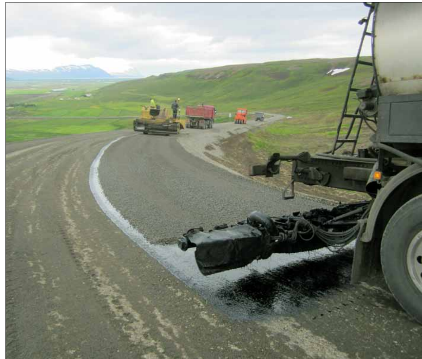
Hvammavegur (853), Stadarbraut - Kísilvegur. Styrking og endurbætur 2,4 km. Klæðing 18. júní 2014. Mynd: Rúnar Jónsson.
