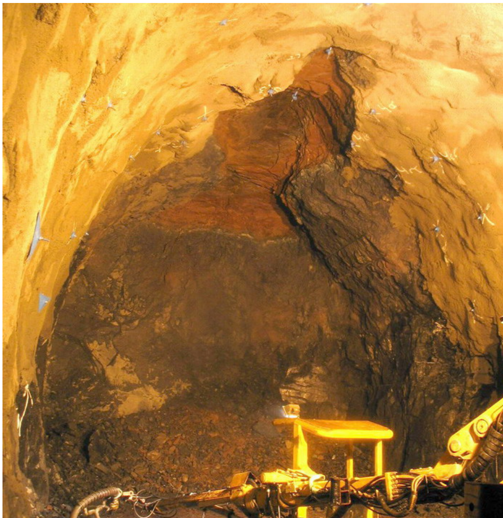
Mynd 5.6. Leirkennd setbergslög sem hafa mjög lágan brotstyrk, valda stundum staðbundinni og óreglulegri víkkun á þversniði ganganna (í veggjum eða lofti). Myndin sýnir dæmi um setbergslög í Fáskrúðsfjarðargöngum (frá árinu 2004) sem talin eru vera hliðstæð mörgum setbergslögum á leið Norðfjarðarganga.
