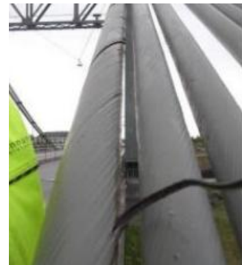
Mynd 8: Brotinn þráður í einum strengja Ölfusárbrúar
