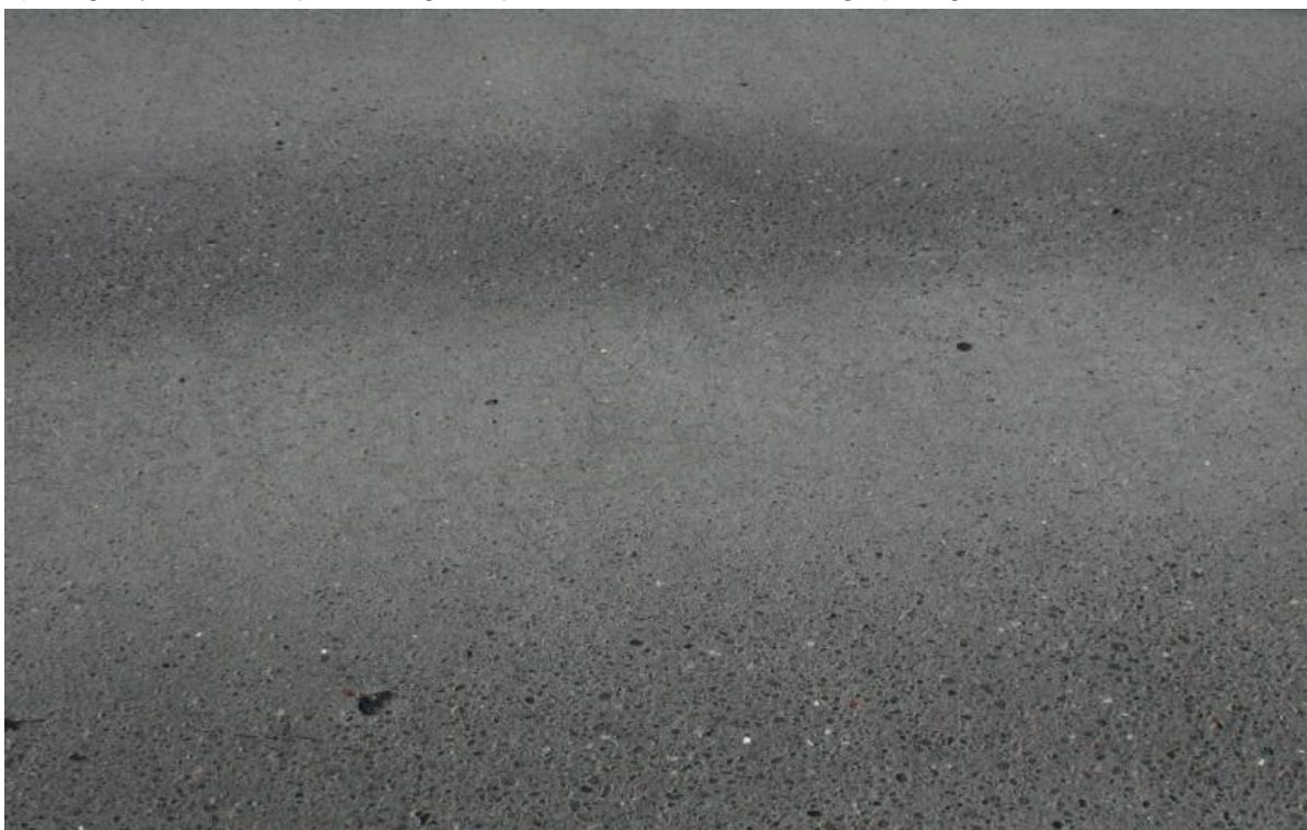
Mynd 26 – hugsanlega markar fyrir sprungu í miðri mynd
