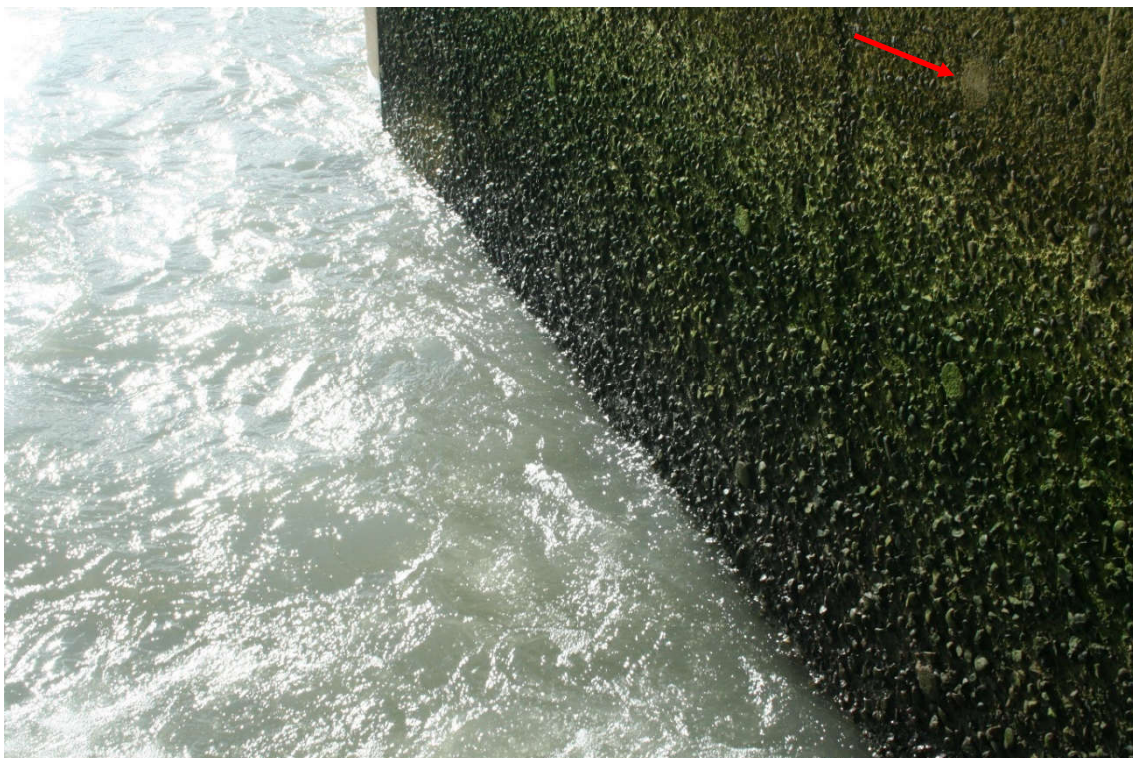
Mynd 3. Óseyrarbrú, stöpull 5. Flögnun í steypunni fyrir neðan meðal fjörumörk. Rauða örin bendir á sama kónagat og örin bendir á, á myndinni hér fyrir ofan. Flögnun úr yfirborði er áætluð allt að um 30 mm. Neðstu fjörumörk eru ekki alveg komin í ljós.
