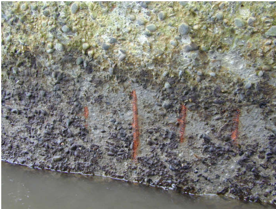
Mynd 1. Borgarfjarðarbrú, neðstu fjörumörk. Steypuhulan hefur flagnað af og óvarið bendijárn komið í yfirborð. Yfirborðsflögnun er allt að um 50 mm, en steypuhulan var um 50 mm. Myndin er tekin árið 2000.
