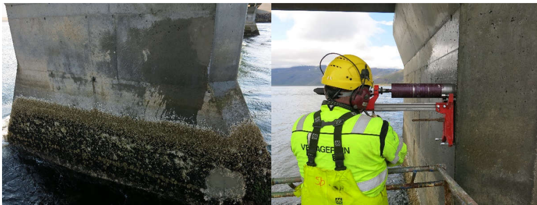
Mynd 6. Kolgrafafjarðarbrú. Engar skemmdir voru sjáanlega í yfirborði steypunnar, t.v. Kjarni boraður úr efri fjörumörkum t.h.
