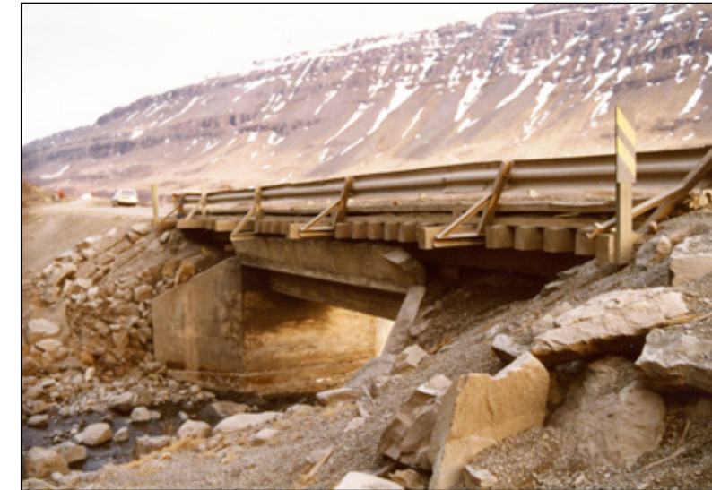
Brunná með timburyfirbyggingu frá 1977 sem þarna er orðin nokkurra ára og farin að láta á sjá. Jakob Hálfðanarson tæknifræðingur tekur undir það að sómakærir brúahönnuðir voru ekki ánægðir með að þurfa að skila frá sér svona klasteri en annað var ekki í stöðunni á meðan ekki hafði verið ákveðið hvar endanleg vegtenging um Hvalfjörð ætti að vera.
