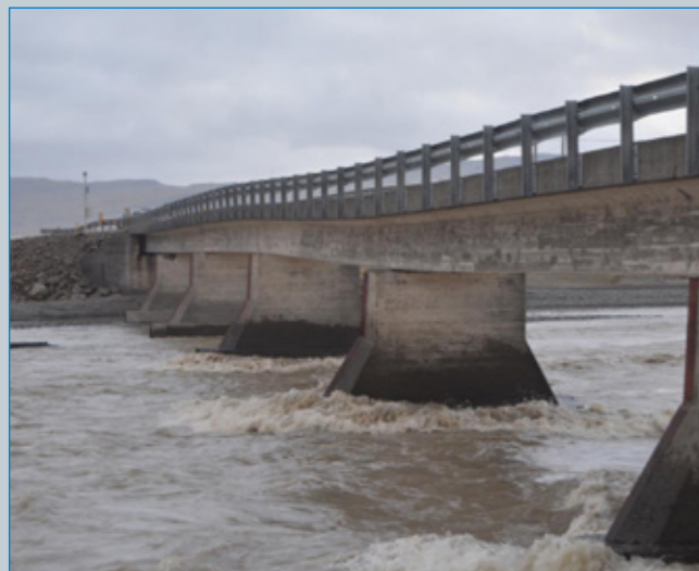
Steinavörn, millistöpull hangir í yfirbyggingu.
