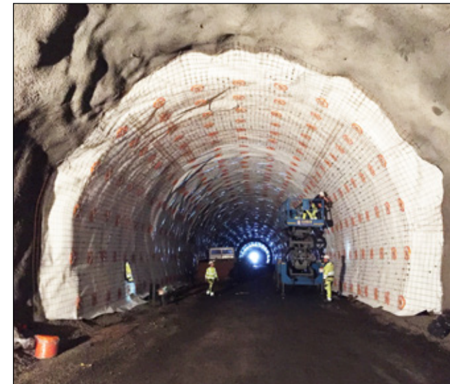
Vatnslæðing sett upp 11. júlí 2016.
