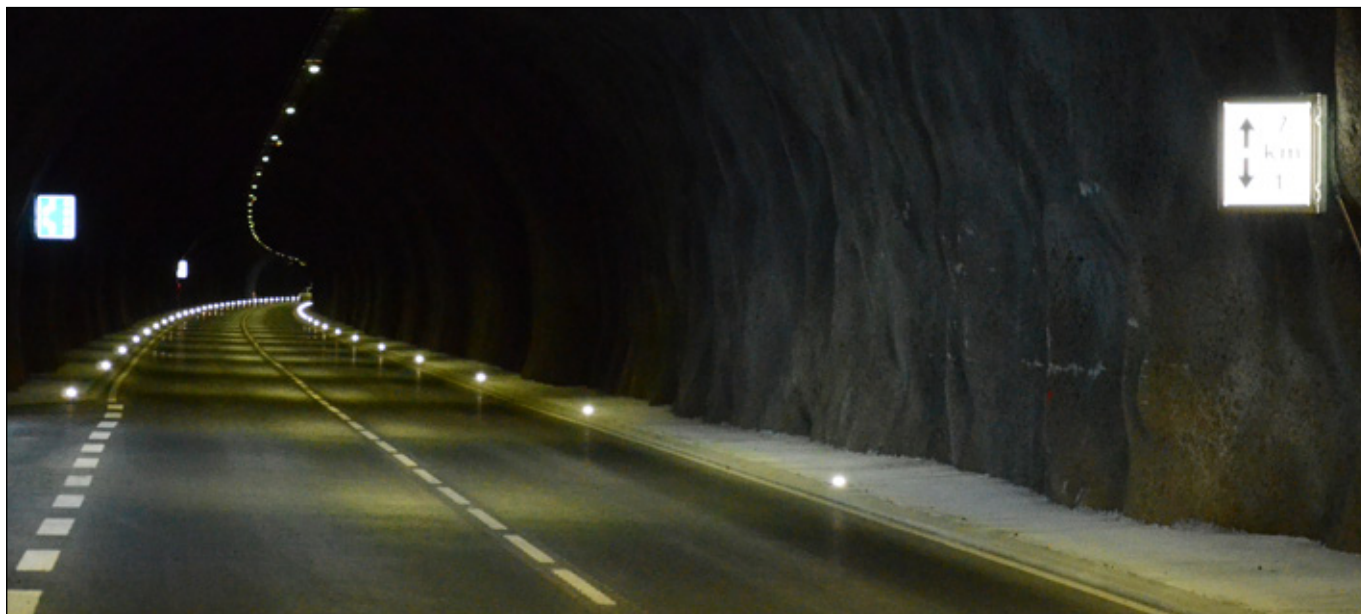
Norðfjarðargöng á vígsludegi. LED-ljós sem afmarka akbraut er nýjung hér á landi og koma í stað vegstika.
