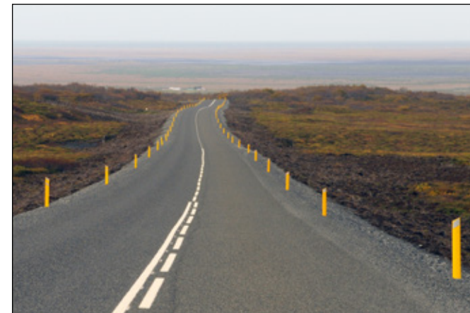
Nýrsti hluti Dettifossvegar. Frágengið svarðlag við veg sem byggður var árin 2014 til 2016.
