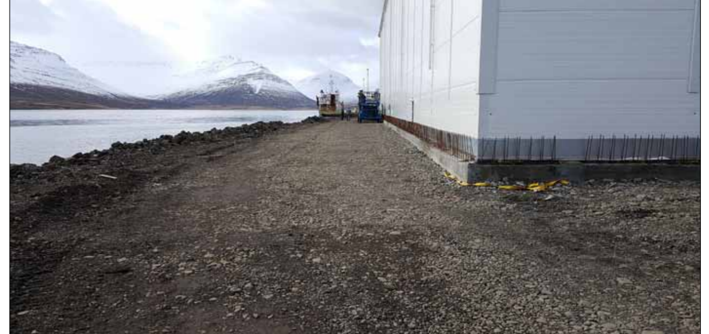
Fáskrúðsfjörður. Samkvæmt útbóði skal byggja bryggju framán við nýja frystigeymslu. Bryggjan er úr forsteyptum einingum sem komið er fyrir á stálstaurum. Sjá niðurstöður útbóðs.
