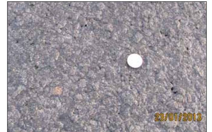
Vetrarblæðing. Það eru örmá göt sem bikbindiefnið þrýstist upp í gegnum þegar þungur bíll ekur um veginn. Til samanburðar er 100 kr. mynt. Bindiefnið í yfirborðinu er annars stíft og heilt að sjá.
