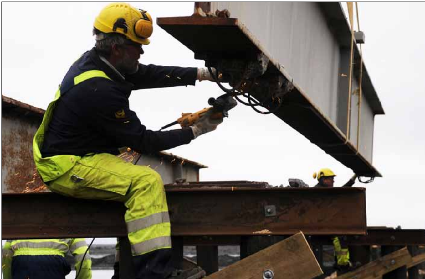
Guðmundur Sigurðsson brúasmíður frá Hvammstanga lagferir stálbita áður en hann er settur niður á undirstöðu við Múlakvísl.
