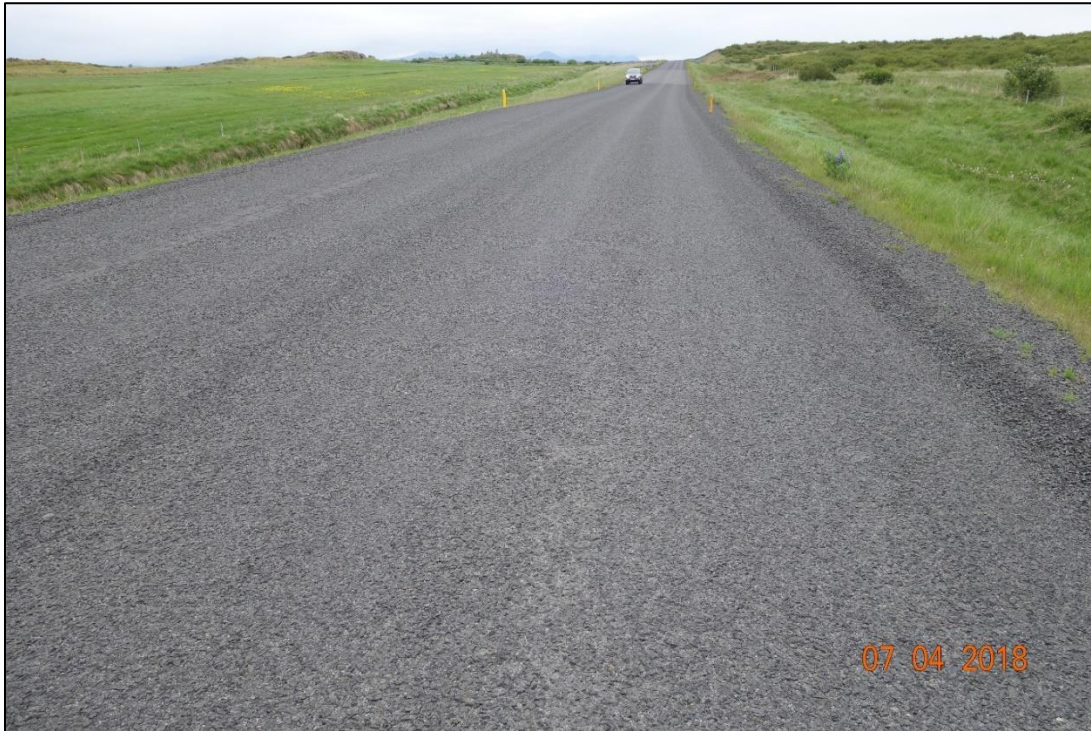
Mynd 18 Viðsnúin klæðing á 1-h0 við kaflaskilin í stöð 1632
