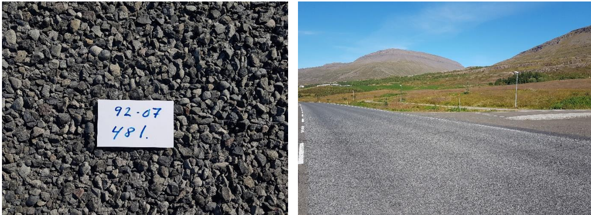
Mynd 14 a) og b) Bikþeytuklæðing við úttekt 30. ágúst 2017 á kafla 92-07, stöð 481
