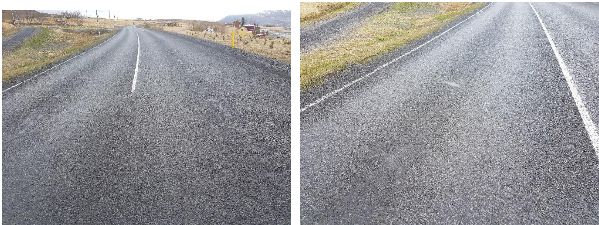
Mynd 13 e) og f) Bikþeytuklæðing við úttekt 9. maí 2018 á kafla 92-06, stöð 2277
