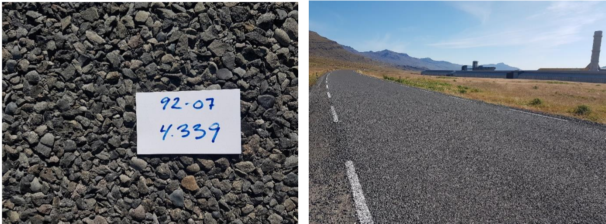
Mynd 15 a) og b) Bikþeytuklæðing við úttekt 30. ágúst 2017 á kafla 92-07, stöð 4339
