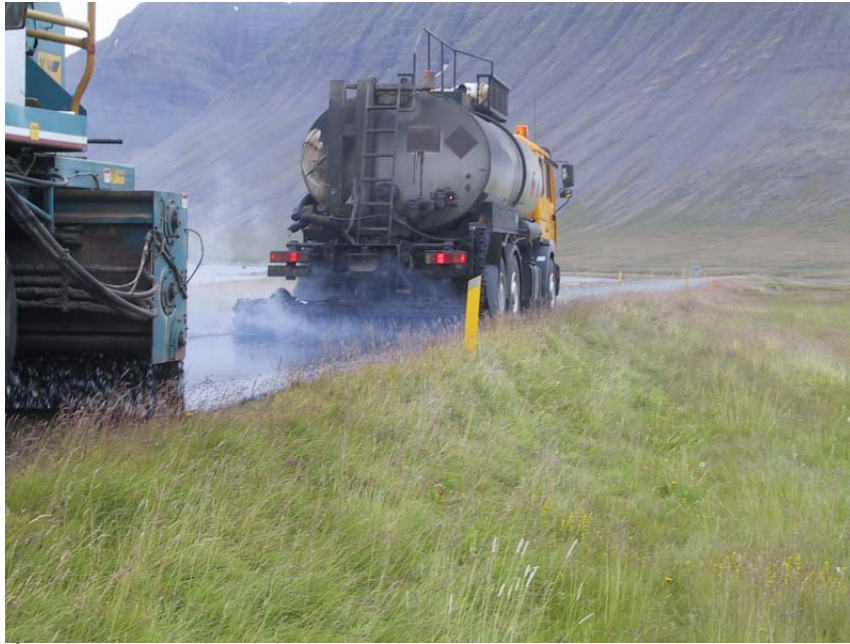
Útlögn á óflokkuðu efni í Öfundarfirði við Vaðal. Lagt á hægri akrein.
