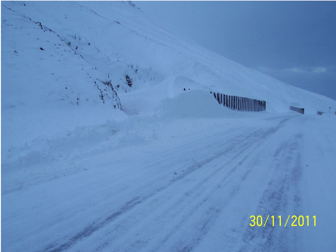
Mynd V2 Flóðsnjór í snjóflóðaskápi við Ólafsfjarðarveg. Stálþilið er um 3,5 m hátt. Ljósmyndir frá Gísla Eiríkssyni.
