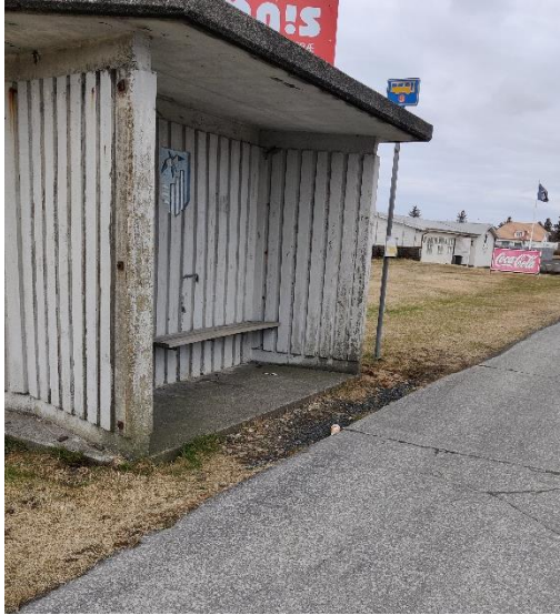
Mynd 3.16 Biðskýli við Hringbraut / Knattspyrnuvöllur. Hér eru 60 cm af grasi / mól sem þarf að þvera til að komast að tímatöflu og inn í biðskýli. Æskilegt væri að leggja hellur / steypa á milli biðskýlis og gangstéttar
