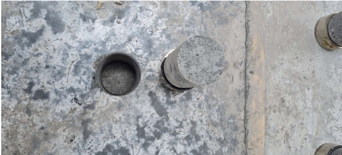
Mynd 24: Slitið varð í bindingi milli slitlagsteypu og undirsteypu.
