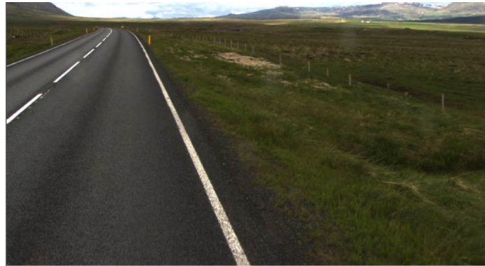
Mynd 28 – Hringvegur (1-k8), ræsi í stöð 896 sumarið 2018.
