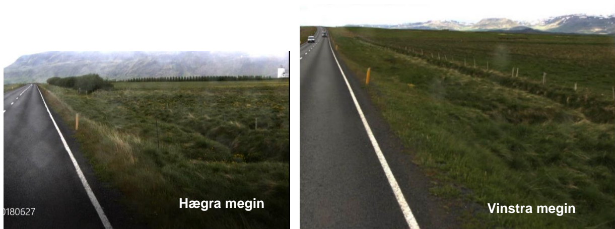
Mynd 32 – Hringvegur (1-k8), ræsi í stöð 1820/1824 sumarið 2018.
