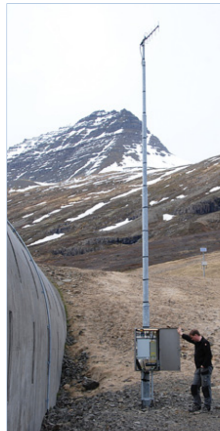
Fáskrúðsfjarðargöng, fjarskiptaskápur, 10. maí 2012.
