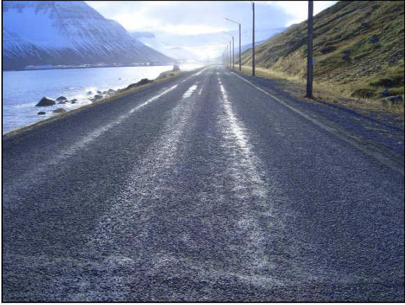
Mynd 13. Kafli H-1 Austmannsfall með 11-16 mm steinefni. Myndin er tekin í átt að Ísafirði (inn eftir, í sömu átt og lagt var út). Ekki er gott að sjá í sólarglampanum hvort um eiginlegar skemmdir er að ræða, en næsta mynd bendir til að svo sé. Glampinn stafar af feitu yfirborði.
