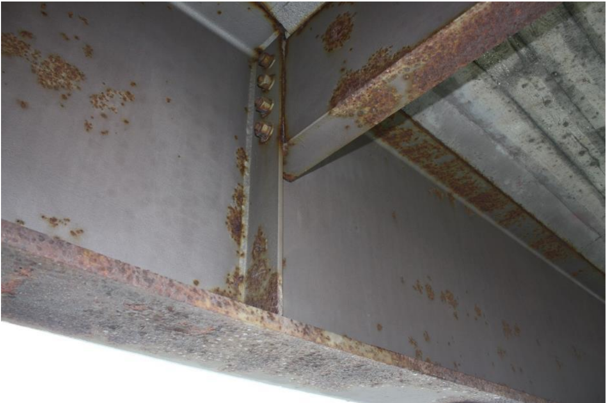
Mynd 10. Neðsta hlið stálbitanna var orðin áberandi ryðguð og illa farin af veðrun. Ljósmynd Sjótækni ehf.
