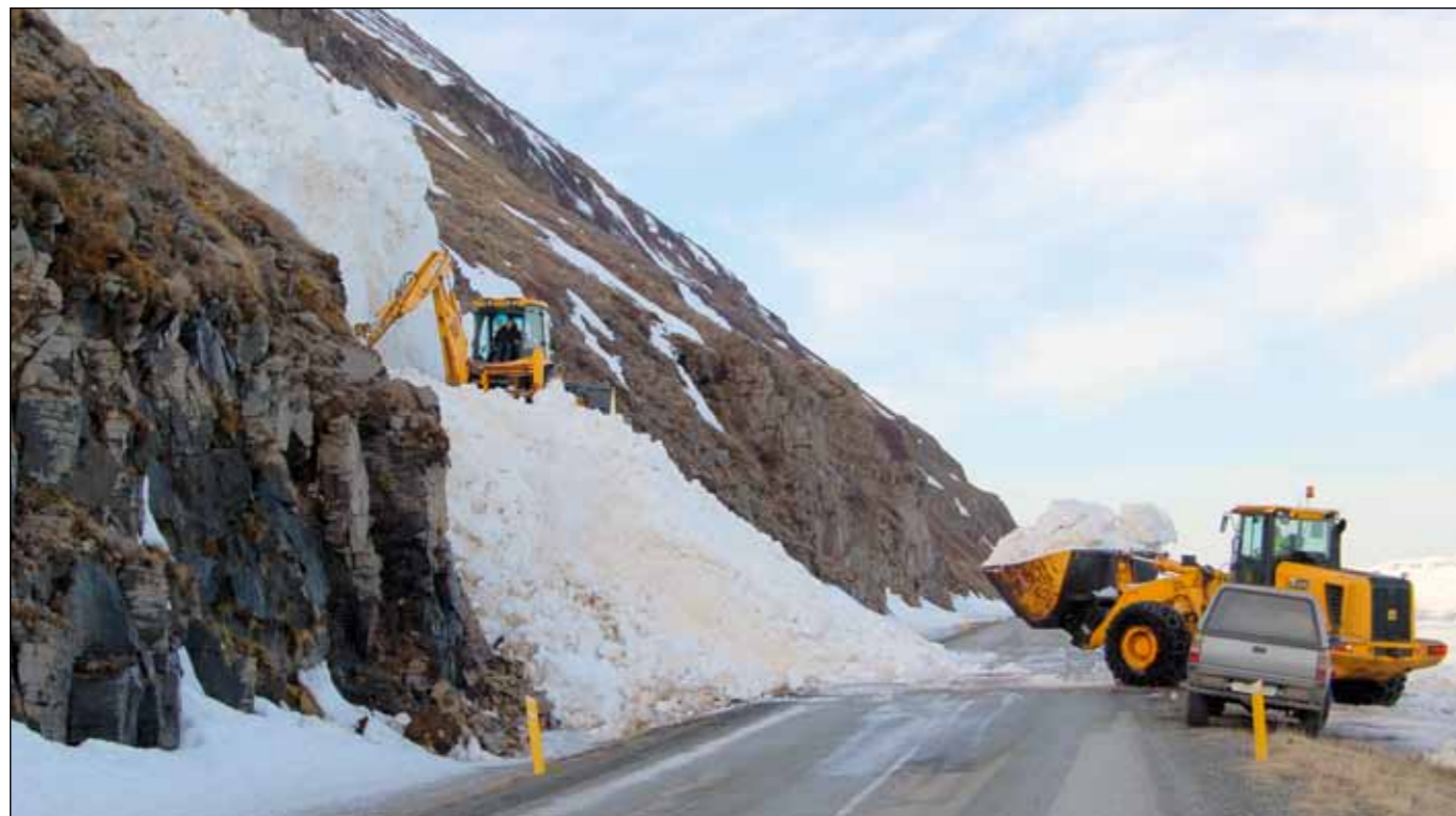
Djúpvegur (61) um Súðavíkurlíð 3. apríl 2014. Hreinsað úr gili númer 20.
