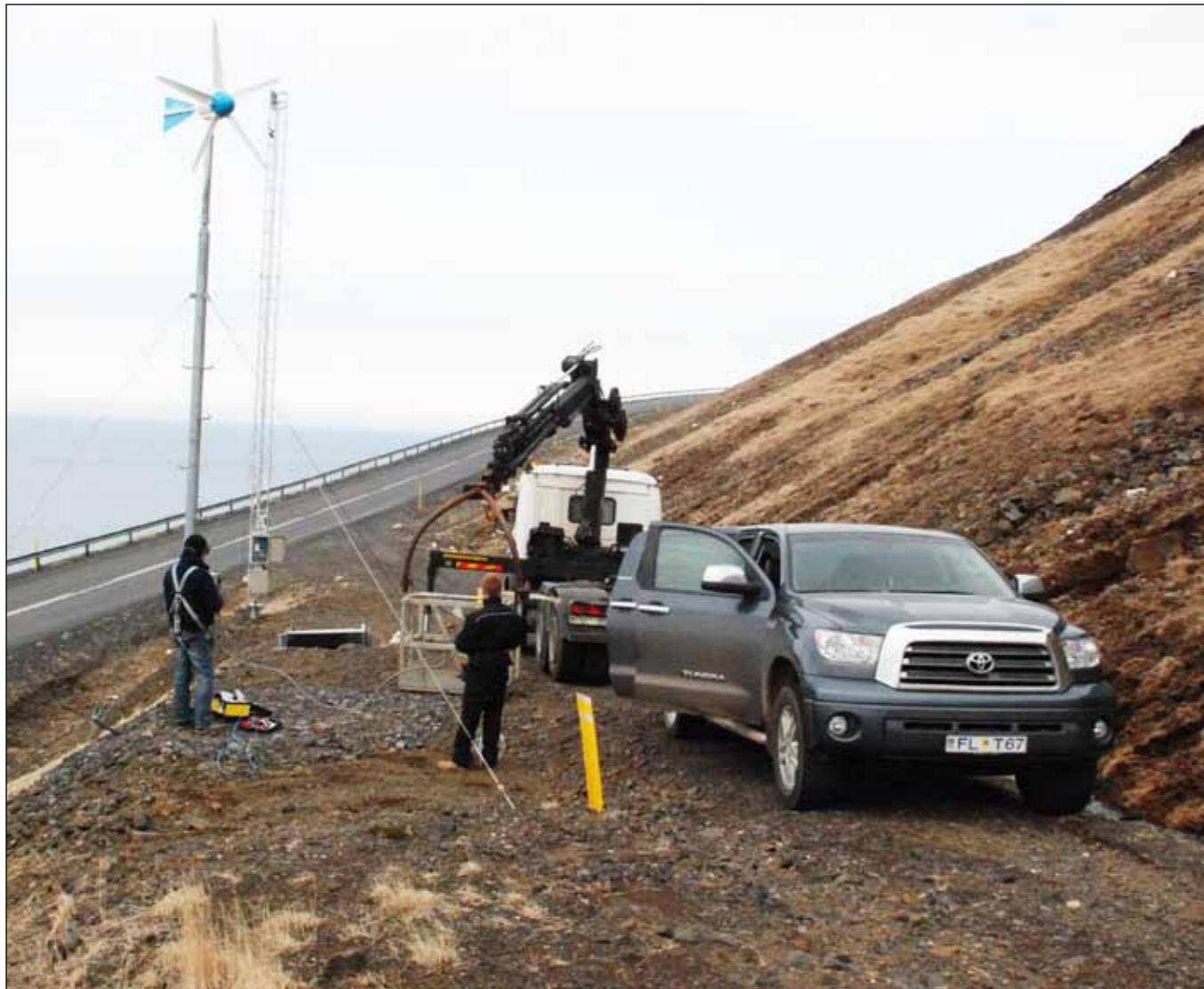
Ný vindraftstöð sett upp við vefmyndavél í Búlandshöfða á Snæfellsnesi. Eldri vindraftstöðvar í rekstri Vegagerðarinnar hafa verið afltílar eða 100 W og hafa þurft um 6 m/sek. vind til að hefja framleiðslu. Nýjar vindraftstöðvar eru 600 W og byrja orkuframleiðslu við vind upp á 2,5 m/sek. Samrekstur með sólarcellum hjálpar mikið upp á öryggið en treysta verður alfarið á vindorku í 10 til 12 vikur í svartasta skammdeginu. Þar er Fjarorka ehf. sem annast uppsetningu á þessum búnaði.
