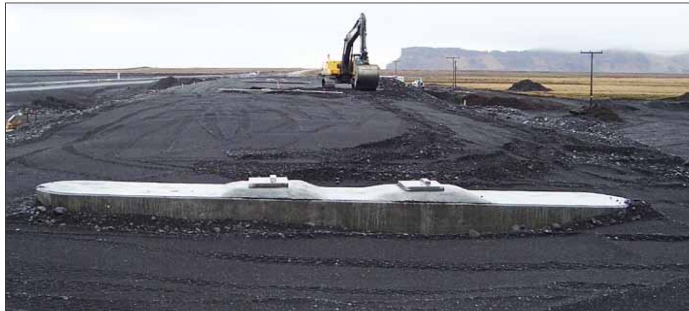
Stöplar nýrrar brúar yfir Múlakvísl bíða þess að hafist verði handa við gerð yfirbyggingar. Að verki loknu verður fyllingarefnið fjarlægt undan brúnni. Hjörleifshöfði í baksýn. Mynd: Guðrún Þóra Gardarsdóttir 05.02.2014.
